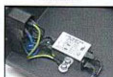
電源輸入部分
